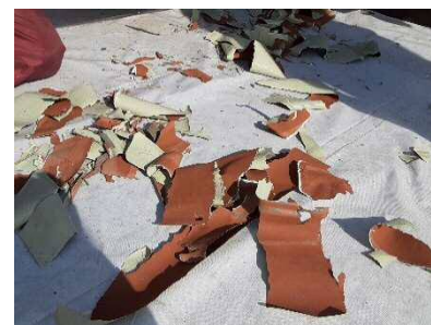
図-2 剥離後の塗膜
