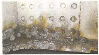
腐食の状況(写真はいずれも首都高速道路会社提供)
