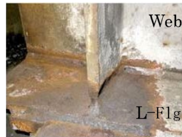
図-1 鋼桁端部の腐食損傷
