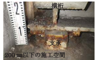
図-11 現場状況(狭隘)
