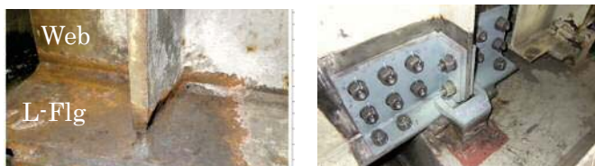
図-1 桁端部付近の腐食
