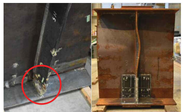
腐食あり・無補強
